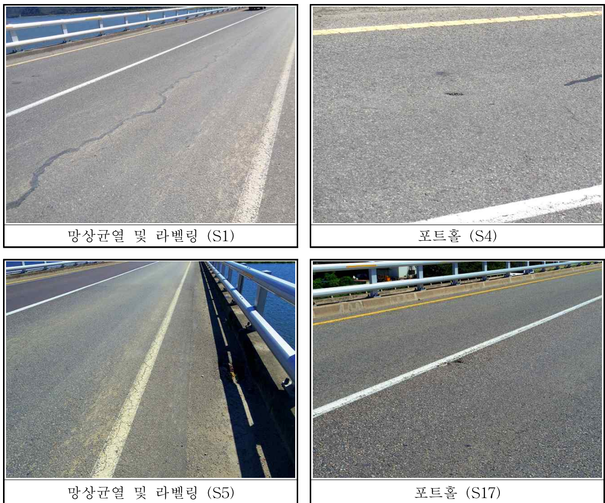
【그림 3.5】 교면포장 손상 현황
