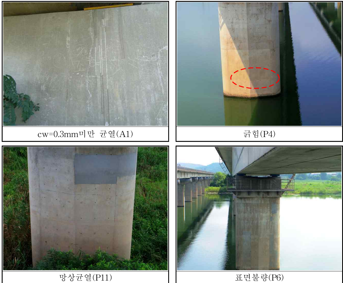
【그림 3.19】 교대 및 교각 손상 현황
