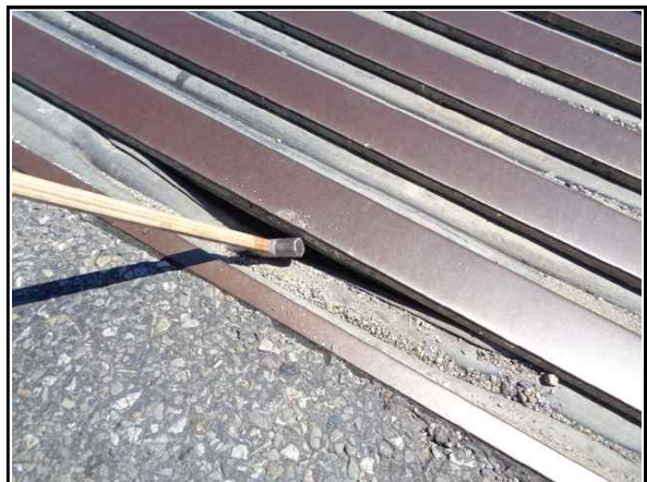
본체 고무재 파손(Exp.2)
