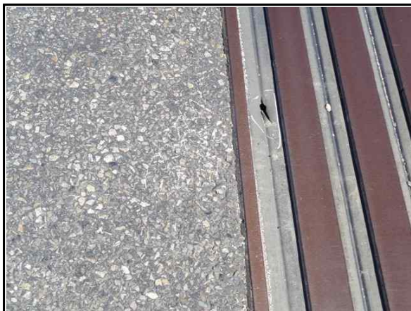
본체 고무재 파손(Exp.2)
